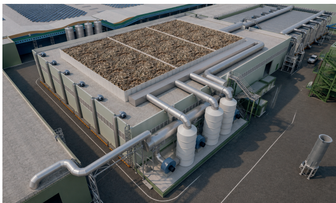
➤ Dettaglio biofiltro per trattamento arie esauste
